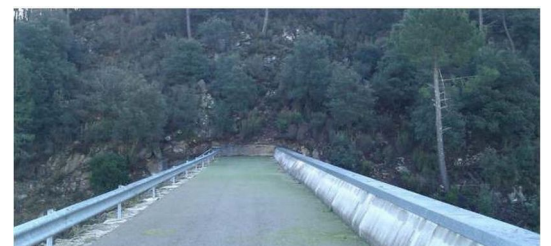
Figure n°5 : état actuel de la crête
